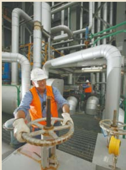
平贾拉改进项目通过废热发电及其他提高能效的手段，精炼厂的温室气体密度可降低百分之八。
