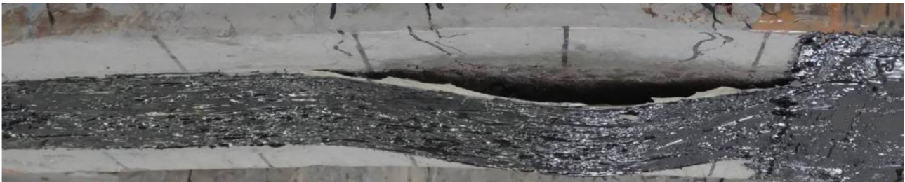
Fig. (21). TM-1 CFRP debonding breakage.
