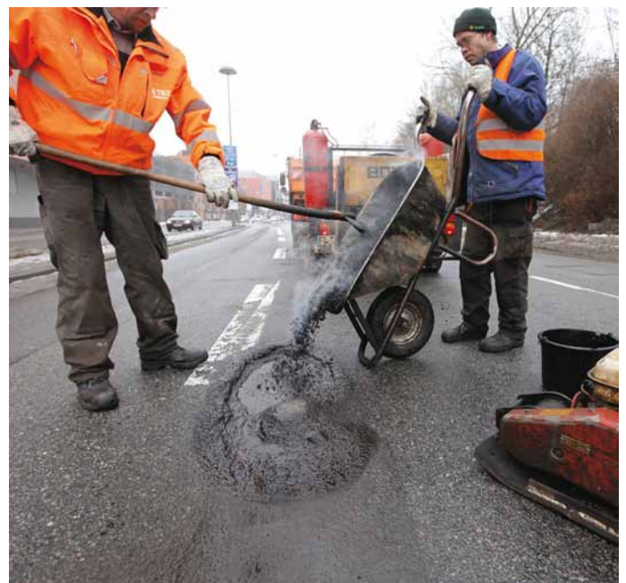
Notdürftige Ausbesserung von Schlaglöchern in der Flensburger Innenstadt. Oft sind es die Gemeinden, die die größten finanziellen Lasten tragen müssen.
