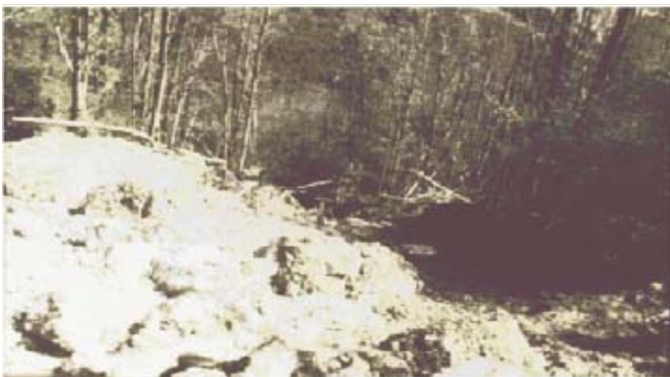
Bild 4.10: Undichtheiten und Auswaschung unter der Wehranlage
