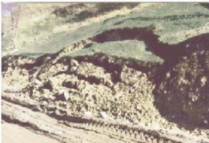
Bild 4.2: Lokale Instabilitäten verursacht durch die Aushubarbeiten
