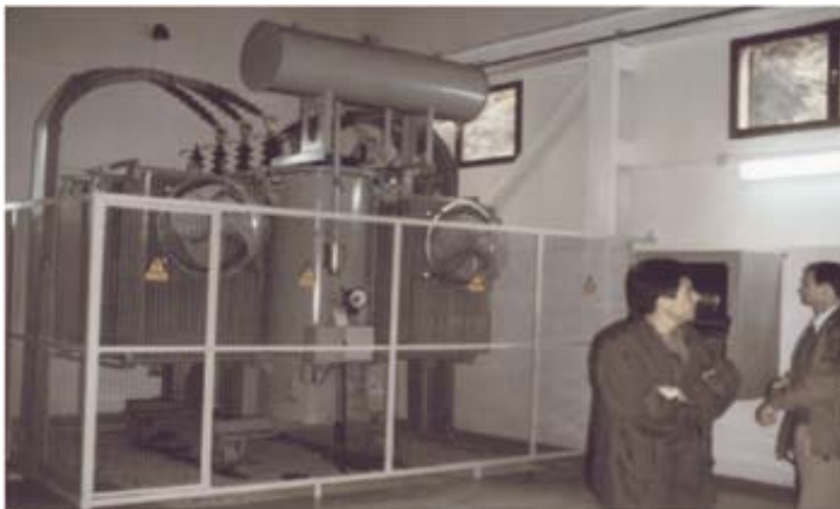
Bild 7.11: Trafoanlage im Kraftwerk
