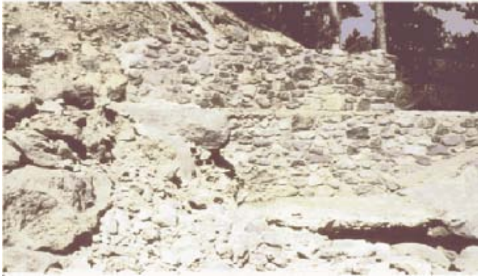
Bild 4.11: Undichtigkeiten und Auswaschung unter der Wehranlage
