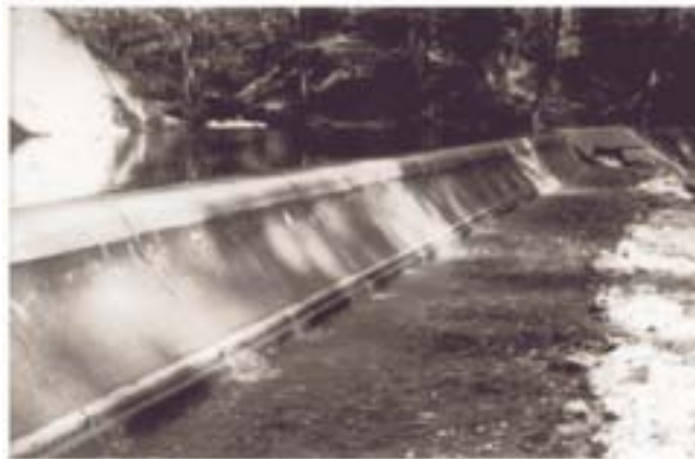
Bild 7.17: Coanda Rechen in Betrieb
