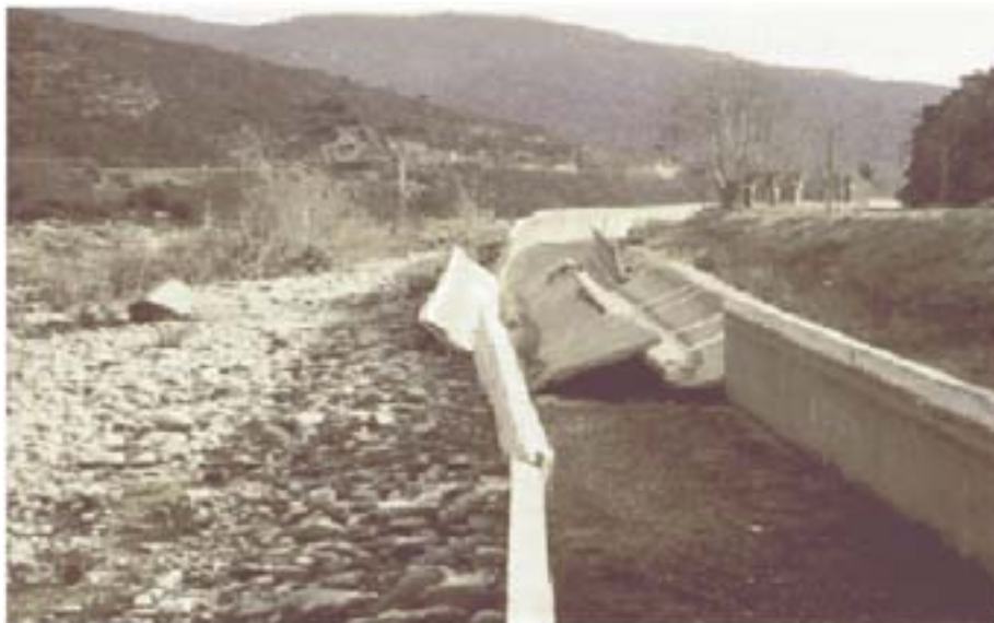
Bild 4.12: durch Auftrieb zerstörter Kanal
