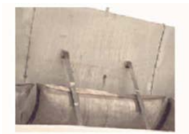
Bild 5.6: Schlauchwehr mit Stahlplatte
