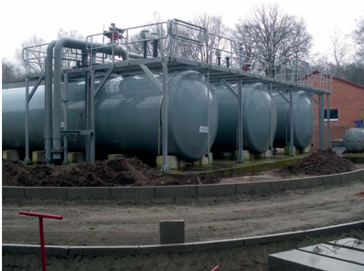
Kontaminationstank als Teil des Central Europe Pipeline System
