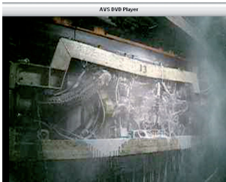
Bild 10. Löschanlage in Betrieb.
