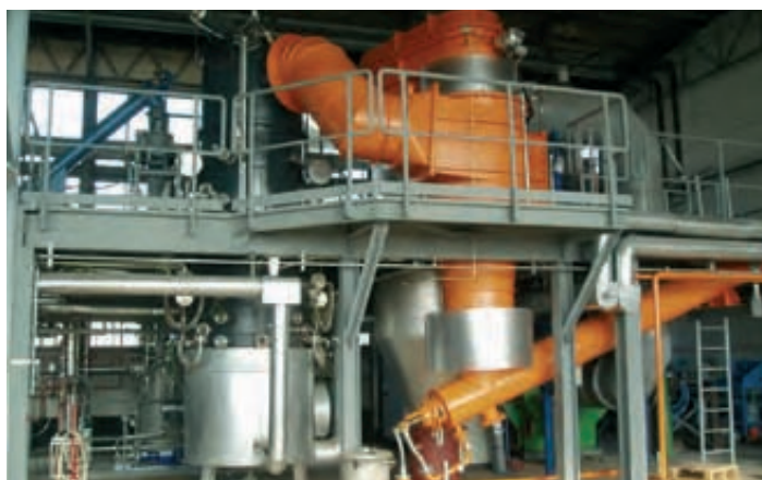
Die CO 2 -arme Technikumsanlage am Kraftwerk Jänschwalde in der Lausitz
