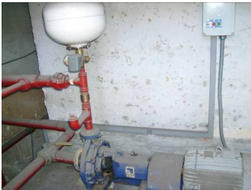
Equipo de presurización para combate de incendio
