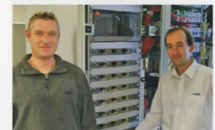
Michael Apel, Christian Stockmar (v.l.) und Konstantin Beder (nicht im Bild) bauen für wilhelm.tel die Kopfstelle auf
