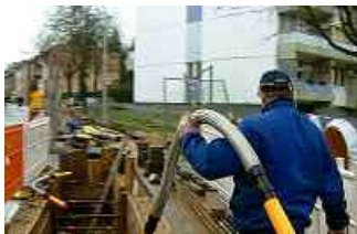
Sickergruben verhindern das weitere Absinken des Grundwasserspiegels
