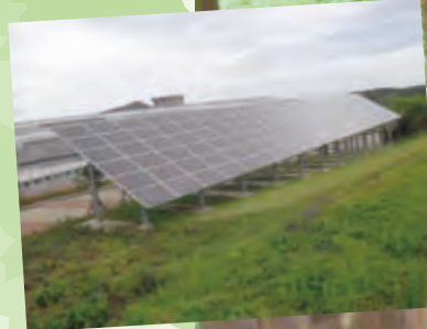
ビジターセンターの敷地に設置された太陽光パネル。センターの電気の一部を賄う
