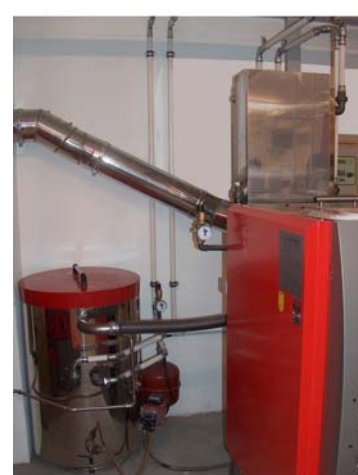
Bild 11 HydroCube 80 kW Ausstellungsraum Frontansicht
