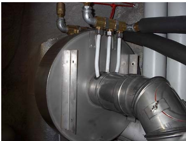
Bild 7 PowerCondenser 40 kW, Feuerungsseite
