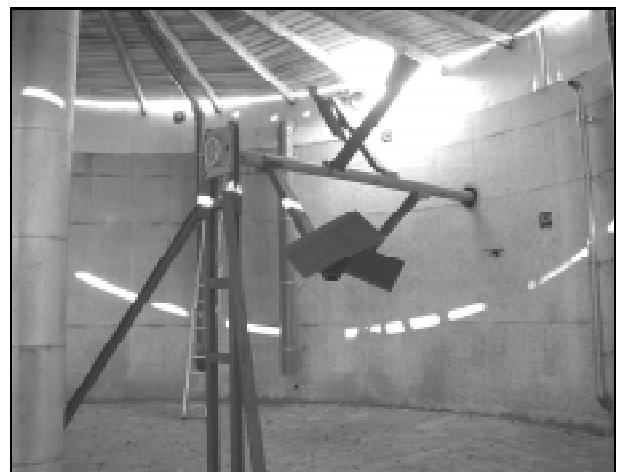
Abb. 3-39: Paddelrührwerk; Foto: PlanET Energietechnik
