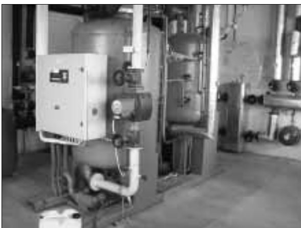
Abb. 5-15: Beispiel einer Absorptionskältemaschine an einer Biogasanlage; Foto: Institut für Energetik und Umwelt gGmbH
