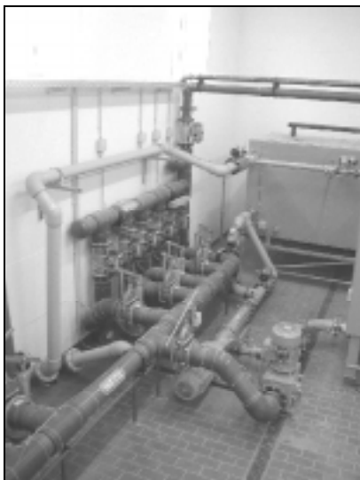
Abb. 3-20: Pumpen in einer Biogasanlage; Foto: WELtec BioPower GmbH
