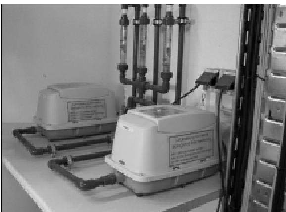
Abb. 5-1: Gasregelung für die Lufteinblasung in den Fermentergasraum; Foto: Institut für Energetik und Umwelt gGmbH
