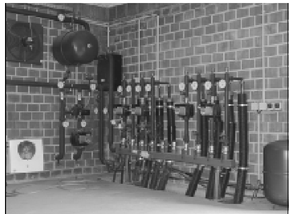
Abb. 5-6: Heizverteiler; Foto: MT-Energie-GmbH
