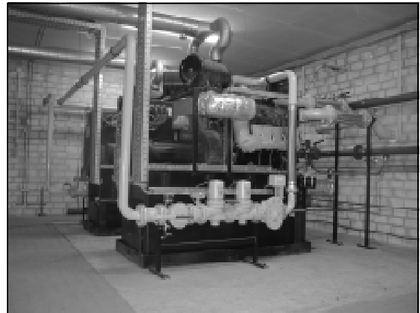
Abb. 5-7: BHKW mit Gasregelstrecke (helle Leitungen); Foto: MT-Energie GmbH
