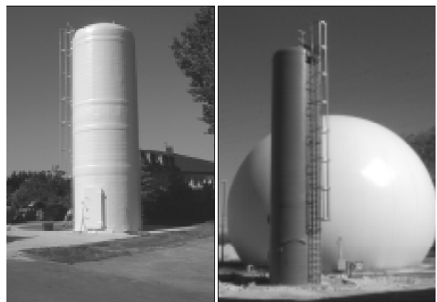
Abb. 5-2: Externe biologische Entschwefelungskolonnen, rechts neben einem Gasspeicher; Fotos: S&H GmbH & Co. Umweltengineering KG
