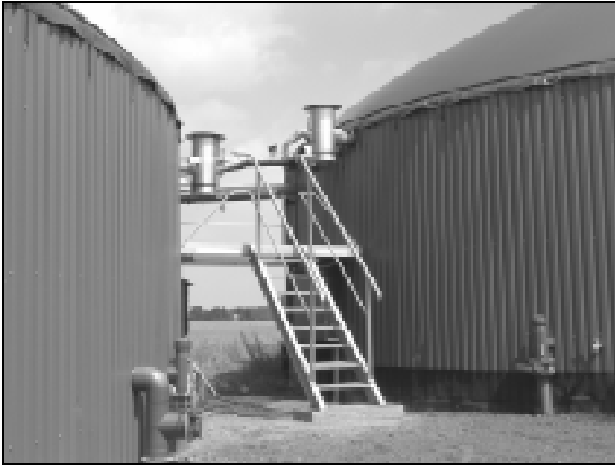
Abb. 3-28: Arbeitsbühne zwischen zwei Behältern mit Rohrleitungen und Drucksicherungen; Foto: MT-Energie GmbH
