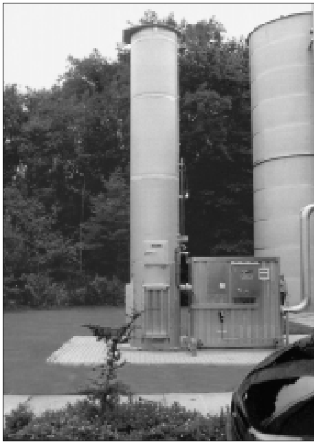
Abb. 3-43: Notfackel einer Biogasanlage; Foto: Haase Umwelttechnik AG
