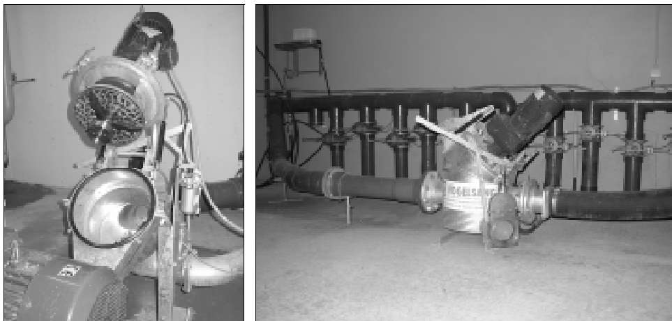
Abb. 3-19: Substratzerkleinerung in der Förderleitung; Fotos: Hugo Vogelsang Maschinenbau GmbH
