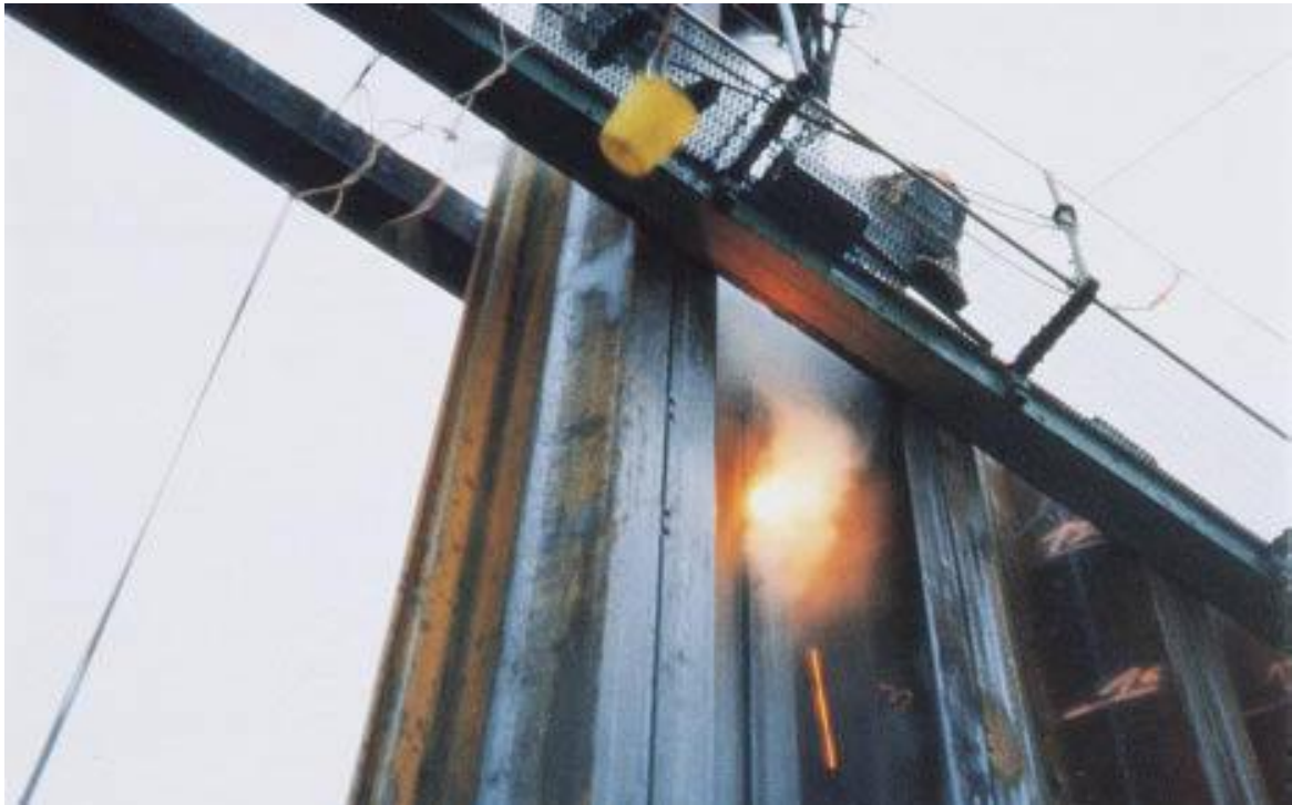
Erwärmung von Spundwandschlössern bei Vibration auf harten Schichten
