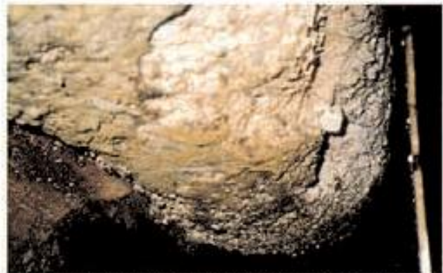
Bild 6: Spundwand mit kleinen Bohrpfehlen im Schloßbereich: freigelegter Bohrpfehl aus Dywidag-Mineralgemisch
