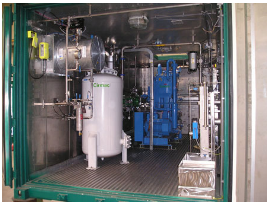
Abbildung 4-12: Membrantrennanlage zur Biogasaufbereitung der Fa. Cirmac (Quelle Fa. Cirmac)
