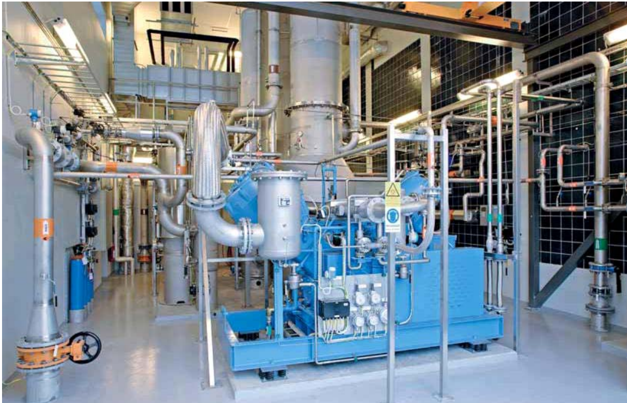
Abbildung 4-2: Druckwasserwäsche in Stockholm (Foto Malmberg)
