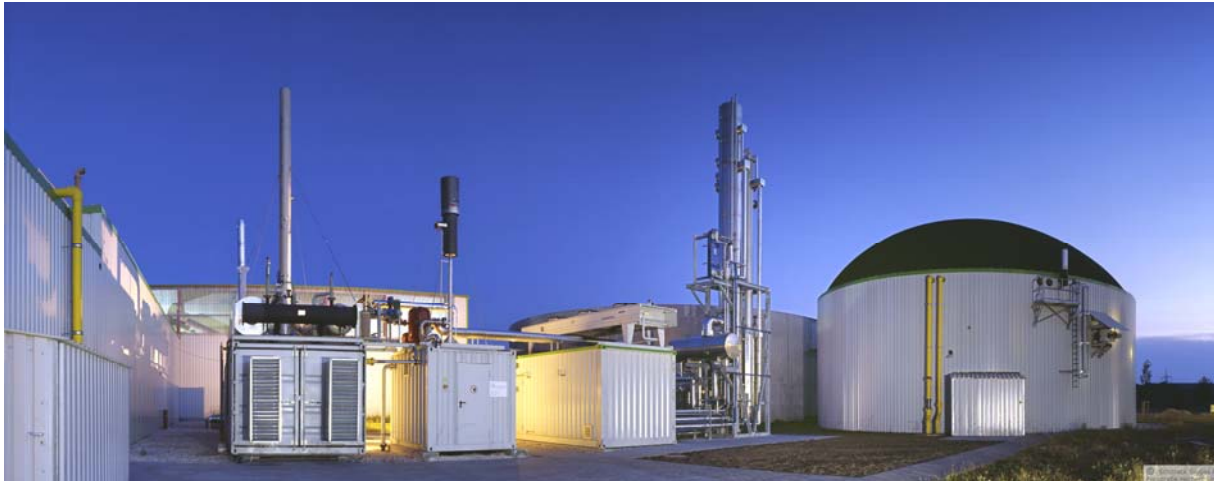
Abbildung 4-8: MEA-Versuchsanlage in Schwandorf (Foto Schmack Biogas AG)
