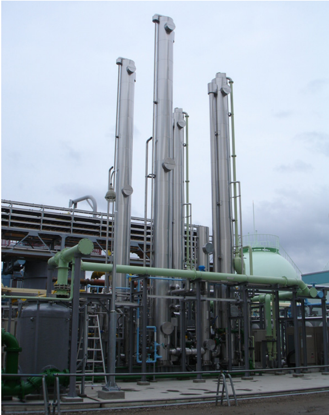
Abbildung 4-4: Flotech-Druckwasserwäsche CSFR-225 in Kobe, Japan (Quelle: Flotech)
