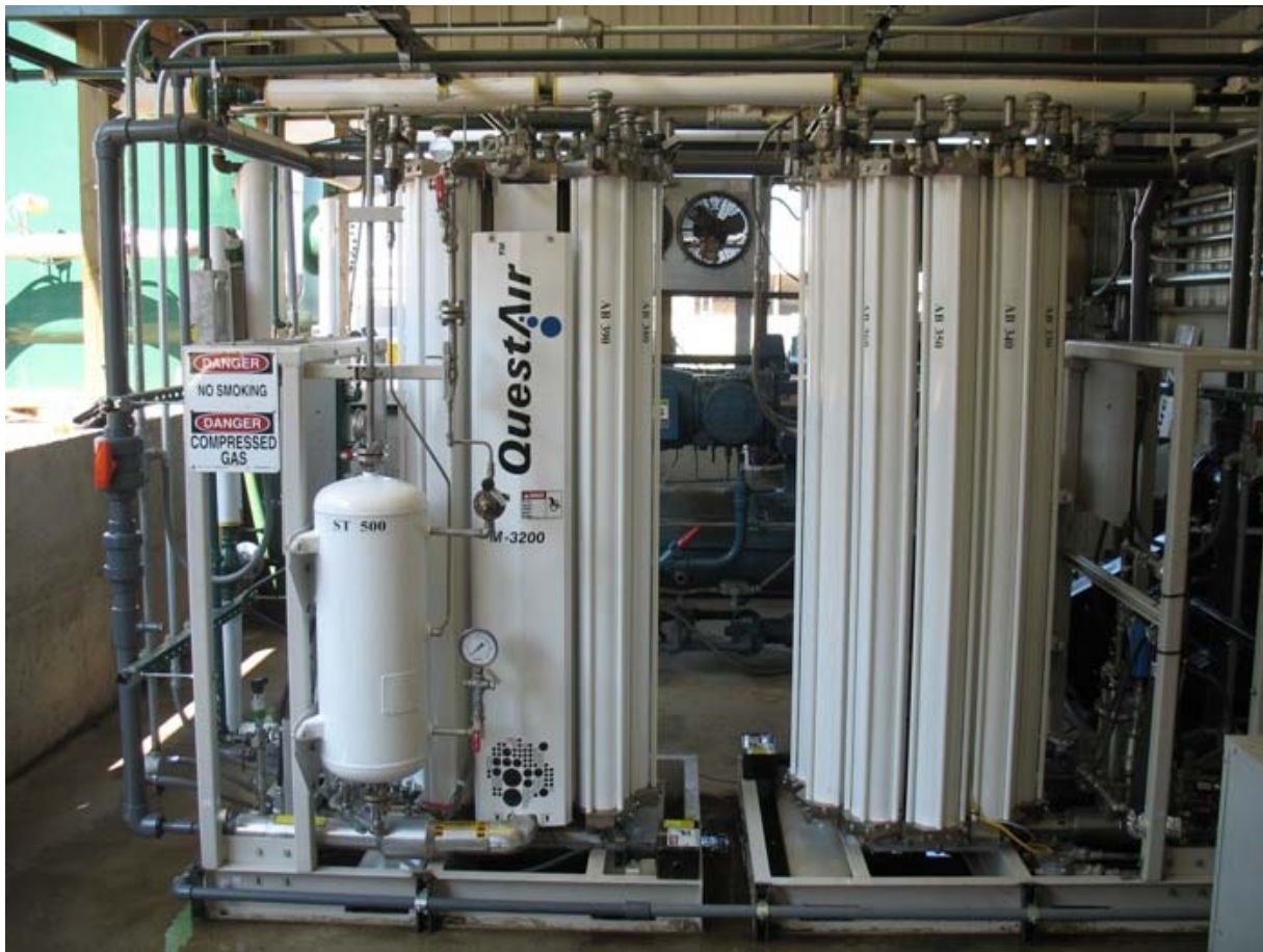
Abbildung 4-9: PSA-Anlage Typ QuestAir™ M-3200 (Foto: QuestAir Technologies Inc.)
