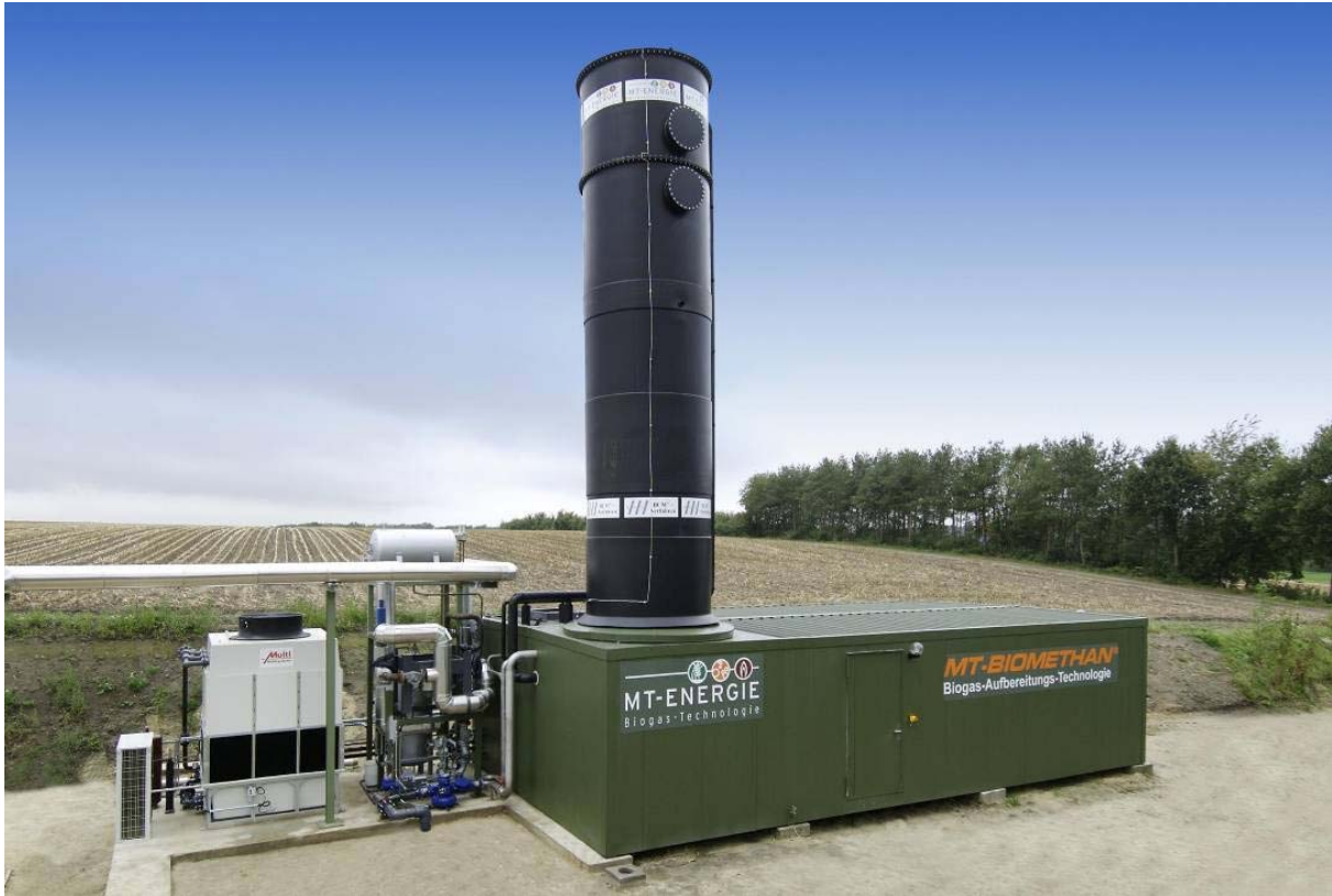
Abbildung 4-14: Pilotanlage in Godenstedt bei Zeven (Quelle MT-Energie 2008)
