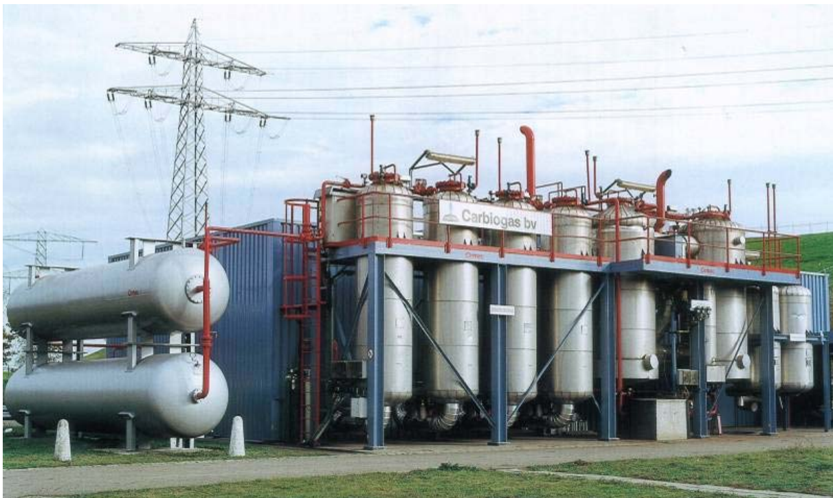
Abbildung 4-10: VPSA-Anlage zur Biogasaufbereitung der Fa. Cirmac (Quelle Cirmac, NL)
