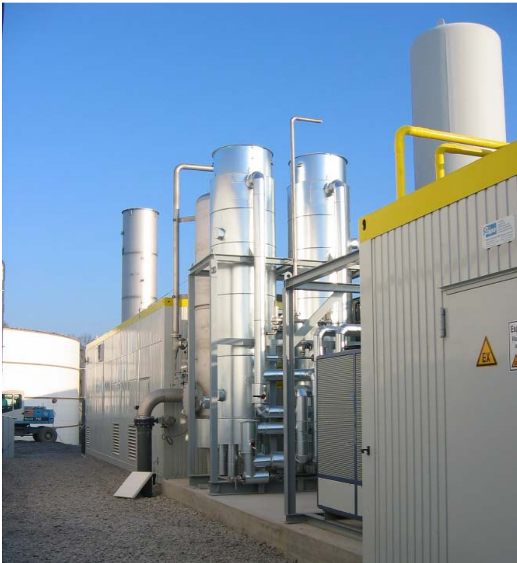
Abbildung 4-7: PSA-Anlage der Fa. Schmack CARBOTECH GmbH in Mühlacker (Quelle: Schmack CARBOTECH GmbH 2008)
