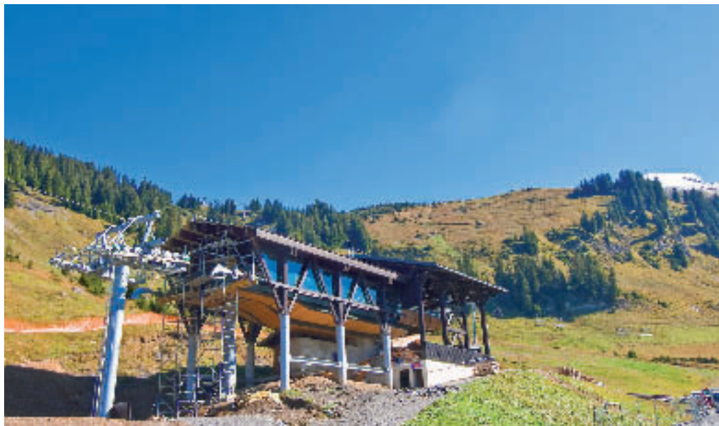
▲ DIE BERGSTATION DER NEUEN MULTIX-9ER-KABINENBAHN DES ARDENT IN AVORIAZ: MEHR KOMFORT, HÖHERE FÖRDERLEISTUNG
