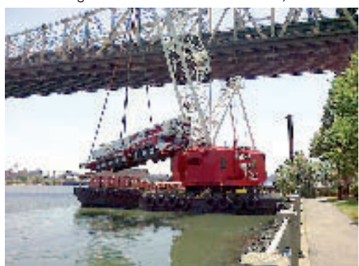
▲ DER FRACHTKAHN AM EAST RIVER MIT SEINEM RIESENKRAN ENTLÄDT DEN KRANWAGEN, MIT DEM DIE NEUEN STÜTZENHÄUPTER DER SEILBAHN AN ORT UND STELLE GEBRACHT WERDEN
