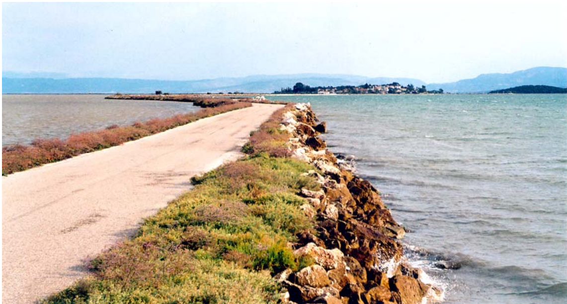
Φωτογραφία 5.4: Ένα από τα φράγματα που διαχωρίζουν τη Λ/Θ Τσουκαλιό (αριστερά) από τη θάλασσα (δεξιά). Στο βάθος διακρίνεται η Κορωνησία.
