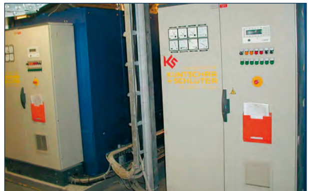
Blockheizkraftwerke zur Energieerzeugung
