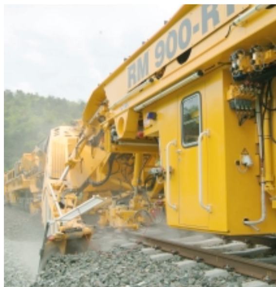
Das HOBCS schafft in der Stunde 400 m Reinigungsleistung
