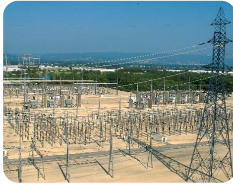
Poste électrique d'EURODIF Production
