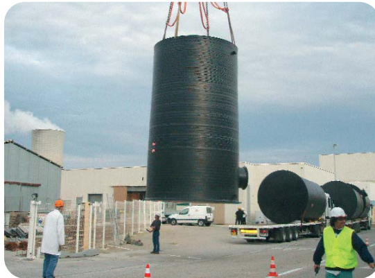
SOCATRI Construction d'une nouvelle station de traitement des effluents uranifères : mise en place d'un réacteur et de son support
