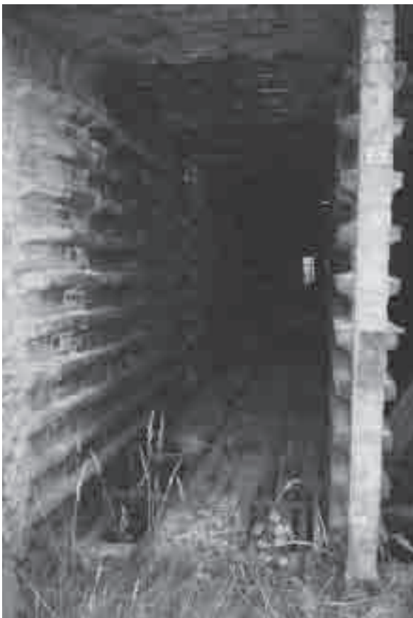
Ziegel 13: Trockenkammer mit Aufnahmeknaggen zur Beschickung mit grünen Steinen überlassen von: Herrn Dr. Borns
