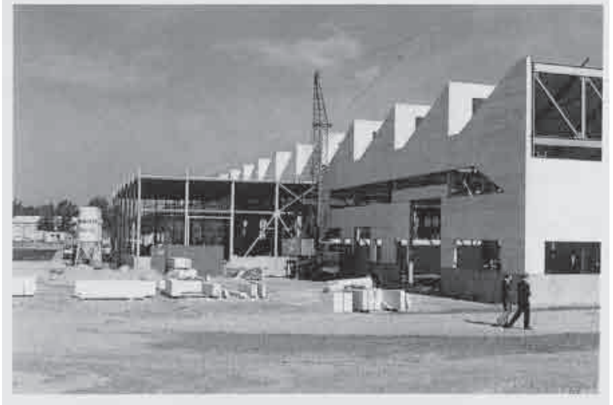
Braas 01: Sprengung des Schornsteins des Kalksandsteinwerkes und Neubau des Betondachsteinwerkes überlassen von: Fa. Braas GmbH Heyrothsberge
