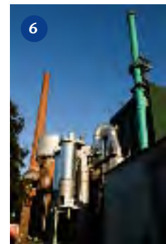
Biomasse-Kraftwerk Fechenheim Alt Fechenheim 34 60382 Frankfurt
