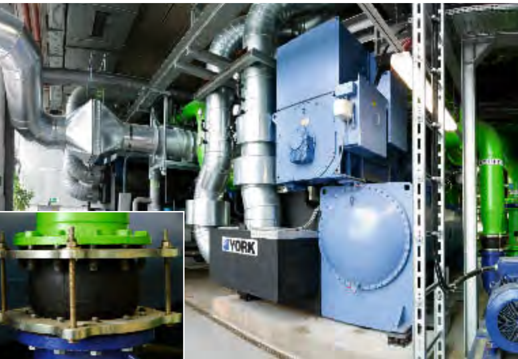
Abb. links: Eine von zurzeit sechs Kompressionskältemaschinen. Da die Anlage sich in einem teilweise als Büro genutzten Gebäude befindet, wird die von den Aggregaten ausgehende Vibration durch entsprechende Dämpfungsmaßnahmen ausgeschaltet (kl. Bild).
