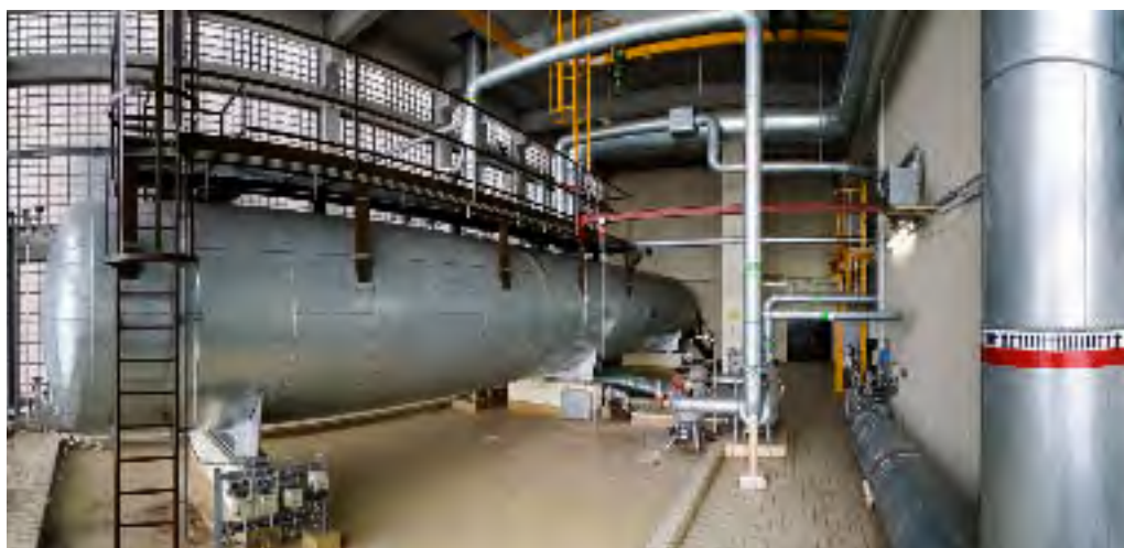
Abb. rechts: Speisewasserbehälter im HKW Messe. Sein Fassungsvermögen beträgt 80.000 l (80 m 3 ).
