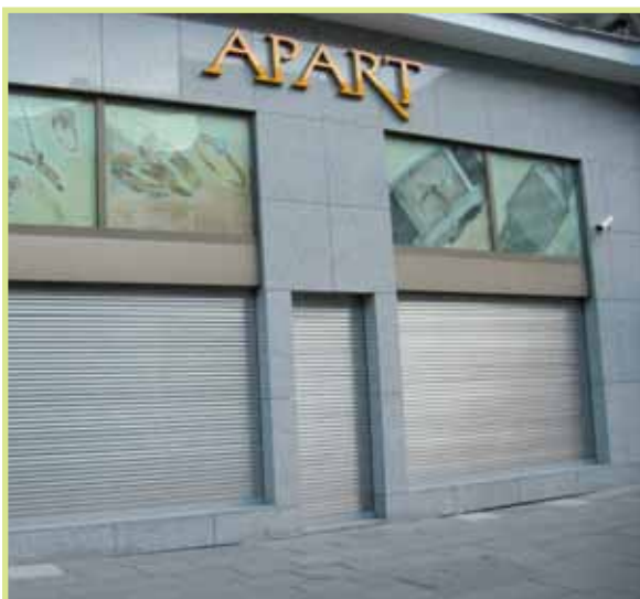
Schaufenster mit einbruchhemmenden Rollläden
