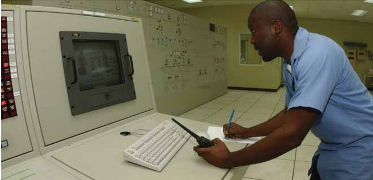
Le rendement de l'exploitation du réseau électrique dans les Bahamas est amélioré grâce à des capteurs et systèmes de commande intelligents et à des techniciens qualifiés
