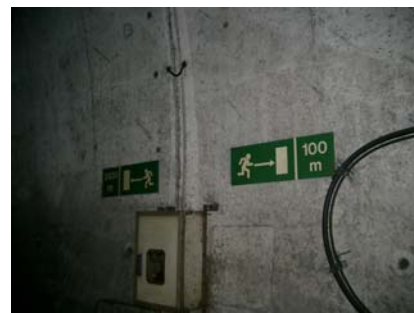
Abbildung 31: Fluchtwegkennzeichnung in Tunneln der SFS
