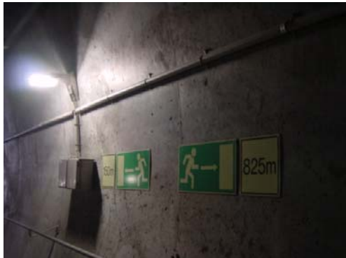
Abbildung 6: Fluchtwegkennzeichnung unter Notbeleuchtung
