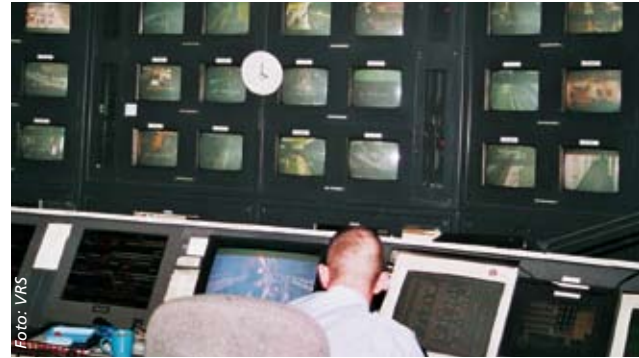
In der Verkehrsleitzentrale laufen die Fäden zusammen.
