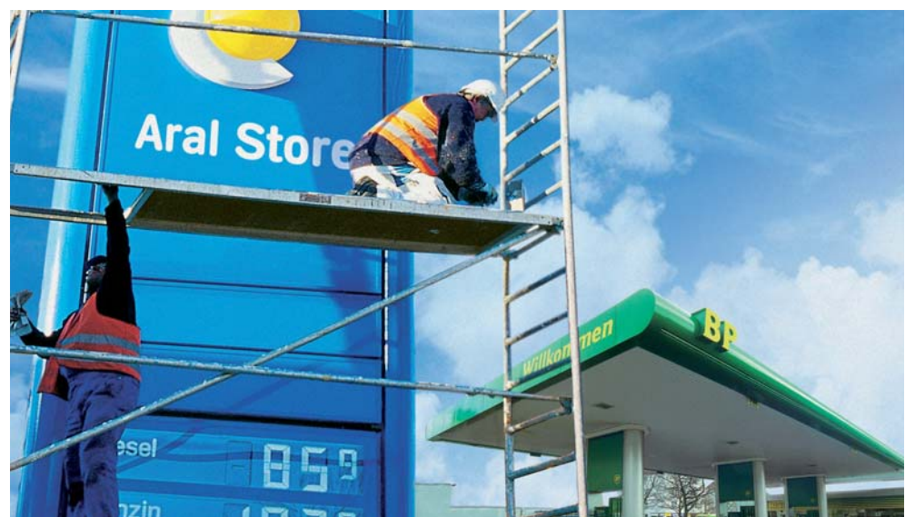
Abbildung 5: Umflaggung einer BP-Tankstelle auf Aral
