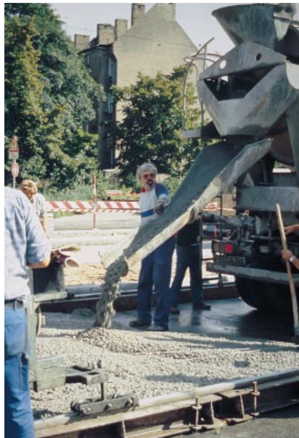
Bild 1: Einbau des Betons mit Fließmittel ohne schwere Einbaugeräte. Der Beton fließt aus dem Fahrermischer über die Rutsche unmittelbar zwischen die vorbereitete Schalung.
