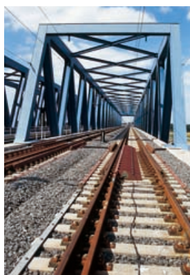
Elbe bei Hämerten: 812 Meter langer Brückenzug mit 240 Meter langer Stahlfachwerkbrücke über dem Strom
