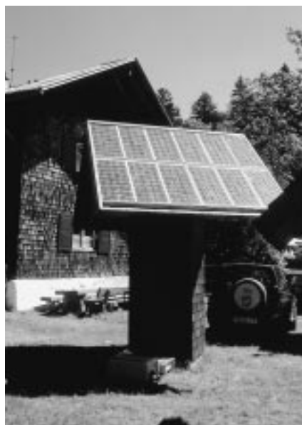
Vorbildlich – die Solaranlage auf Schareben – Strom für die Küche des Berggasthofes.
