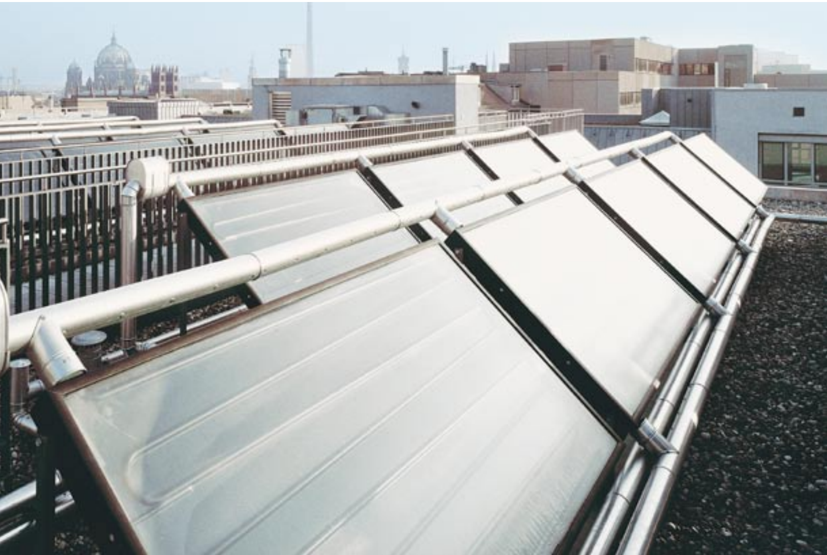
Solarthermie-Anlage auf dem Dach der Vattenfall-Liegenschaft am Gendarmenmarkt
