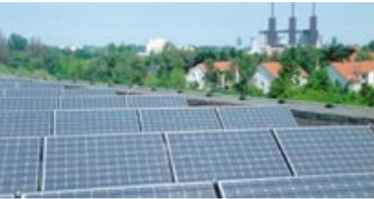
Solaranlage auf dem Dach der Kopernikus-Oberschule
