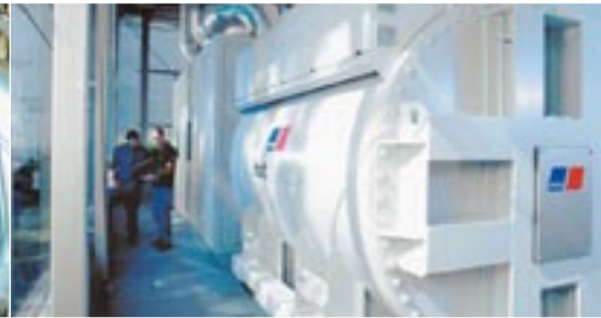
MCFC Brennstoffzelle im Heizwerk Treptow
