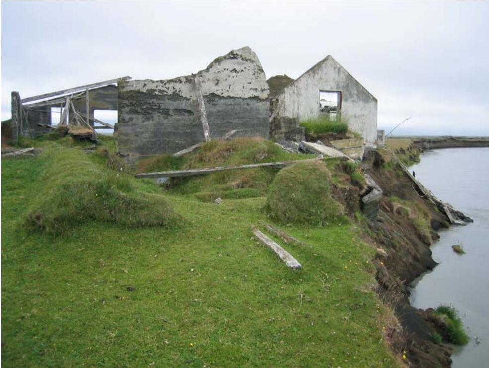
45. mynd: Útihús Bakka í Kelduhverfi (áður stóð Áshúsabakki á sama stað). Bakkahlaup tók íbúðarhúsið fyrir nokkrum árum. Ábúð á Bakka hefur ætíð verið í skugga máttar Jökulsár. Hafa ábúendur oftast ekki þurft að flýja vegna yfirvofandi flóða. Síðustu ábúendur fluttu í burt árið 1964.
